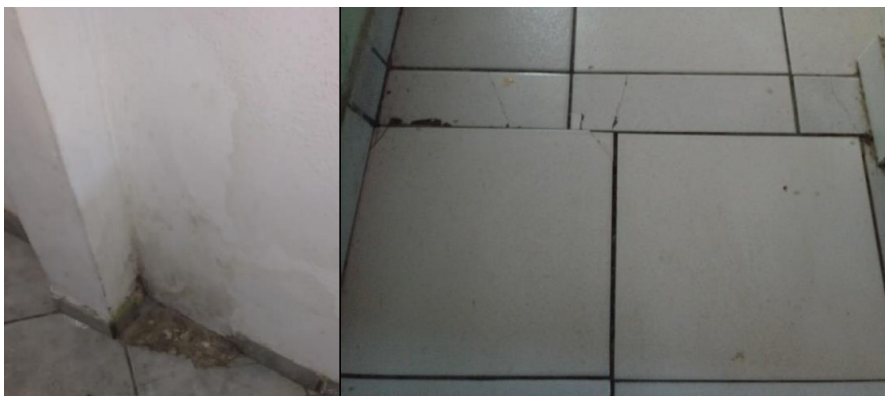
IMAGEM 8. Revestimento cerâmico deteriorado
