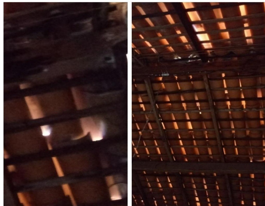
IMAGEM 9. Telhado com presença de goteiras
