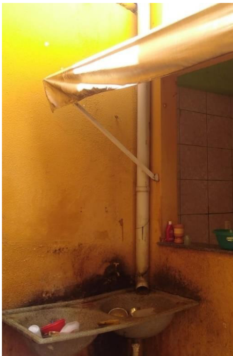
IMAGEM 7. Tubulação de águas pluviais em local inadequado
